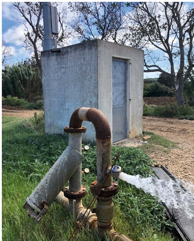
Pozzo di estrazione di acque sotterranee a uso agricolo nell'area della Riserva Naturale Statale di Torre Guaceto (BR).
